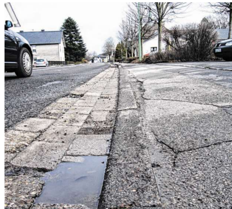
In Strauch muss an der Kölner Straße im Bereich Kirche und Feuerwehr dringend etwas an der Bordsteinanlage getan werden. Foto: P. Stollenwerk
